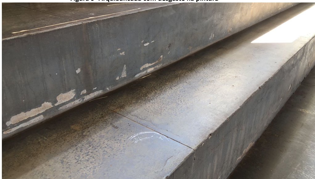
Figura 9- Arquibancada com desgaste na pintura
