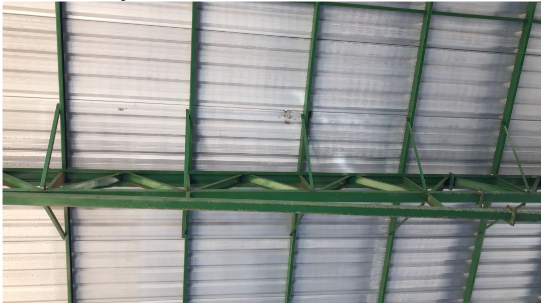
Figura 13 –Foi identificado em uma das telhas orifícios
