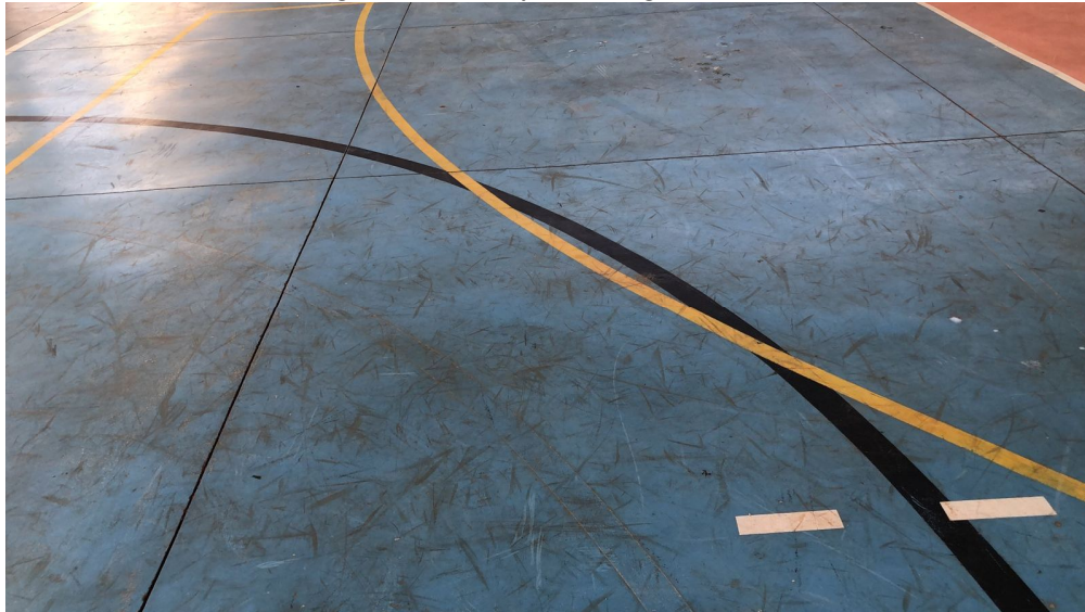
Figura 3- Piso com pintura desgastada
